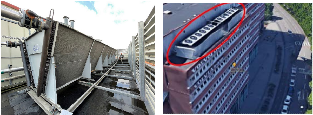
Bild 1 Kylaggregat tillhörande Bohusgatan 15
